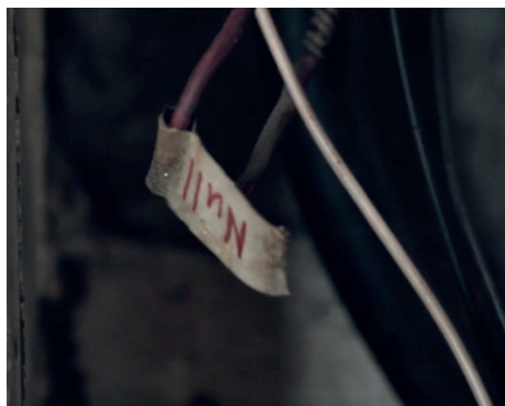
Figura 4. Cable del sótano con marcador en alemán
