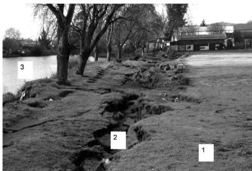
Figura N° 9 Extensión lateral de suelos (EL), laguna Lo Galindo, comuna de Concepción. Vista SW-NE
